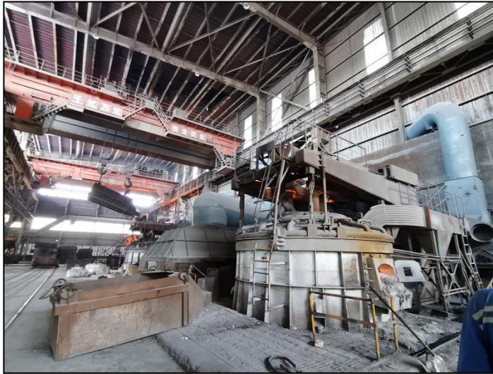
二分厂原有精炼炉 (3500kVA)
